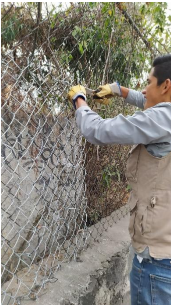
Fig. 20. Cierre de acceso informal.
