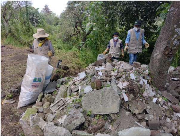
Fig. 36. Acumulación de cascajo previo a su disposición final.
