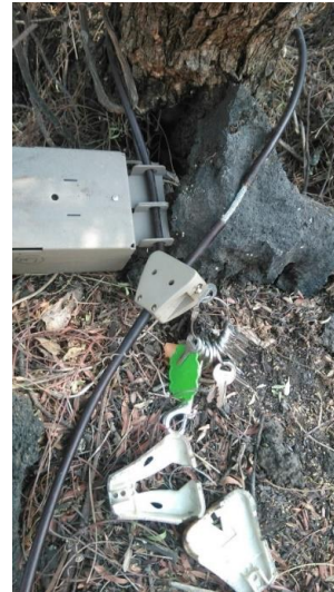
Fig. 25. Fototrampa dañada encontrada en la zona de robo de gasolina.
